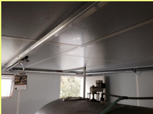
Bild 02: Aufbaubeispiel in Form einer Ringleitung im Milchtankraum. Kann in natürlich jedem anderen Raum und in jeder anderen Form verlegt
